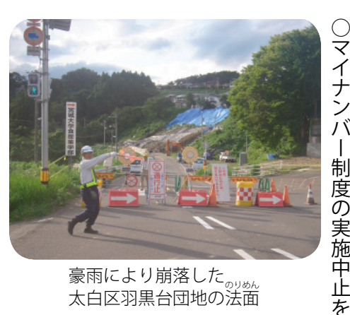
豪雨により崩落した太白区羽黒台団地の路面
