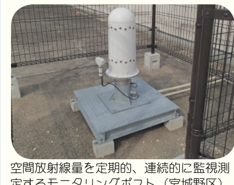
空間放射線量を定期的に、連続的に監視測定するモニタリングポスト（宮城野区）
