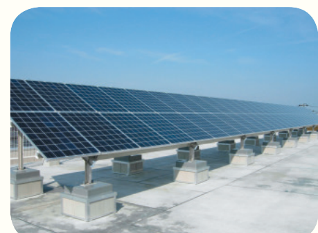
旭丘小学校（青葉区）校舎屋上の太陽光発電パネル
