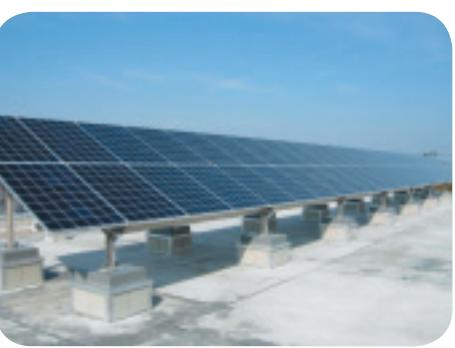
旭丘小学校（青葉区）校舎屋上の太陽光発電パネル
