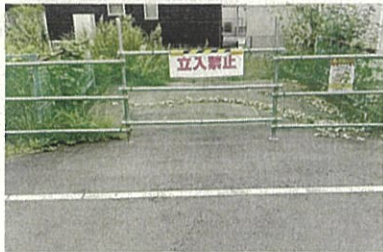
茂庭字中ノ瀬中付近の水路の安全柵
