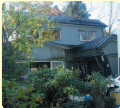
新潟県中越地震で損壊した建物
